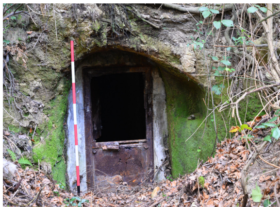
Figura 11. Ingresso di un cunicolo drenante alla base di “12 terzo braccio” della mappa di Lulier (v. Fig. 3), di fronte all'opera di presa terminale Trinità. Da Chiocchini et al. (2023).
