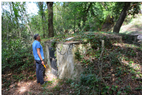
Figura 8. Vasca di raccolta dell'acqua che proviene dai due rami dell'acquedotto, corrispondente a "4 Purgatore" in C della mappa di Lulier (v. Fig. 3).
